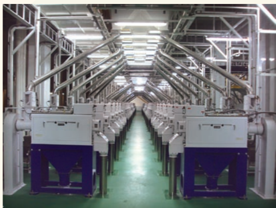
タイの精米工場に設置されたサタケの精米機器
